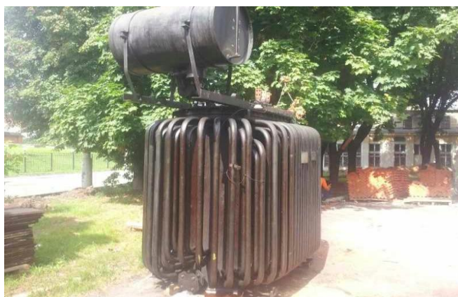
Рисунок 2. Силовой трансформатор 1970 г.в
