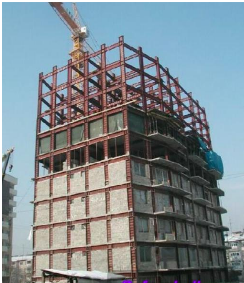
Рис. 5. Рамный каркас 14-этажного жилого дома в г. Алматы с применением двутавров с гофрированной стенкой
