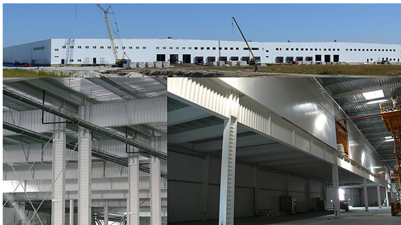
Рис. 11. Овощехранилище в с. Мартусовка, Киевской обл., Украина (площадь 42000 м 2 , вес конструкций 1550 т)
