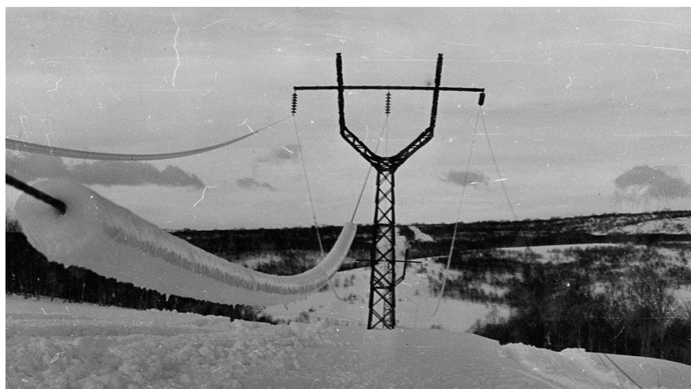
Рисунок 1. Покрытые гололёдом провода ВЛ.
