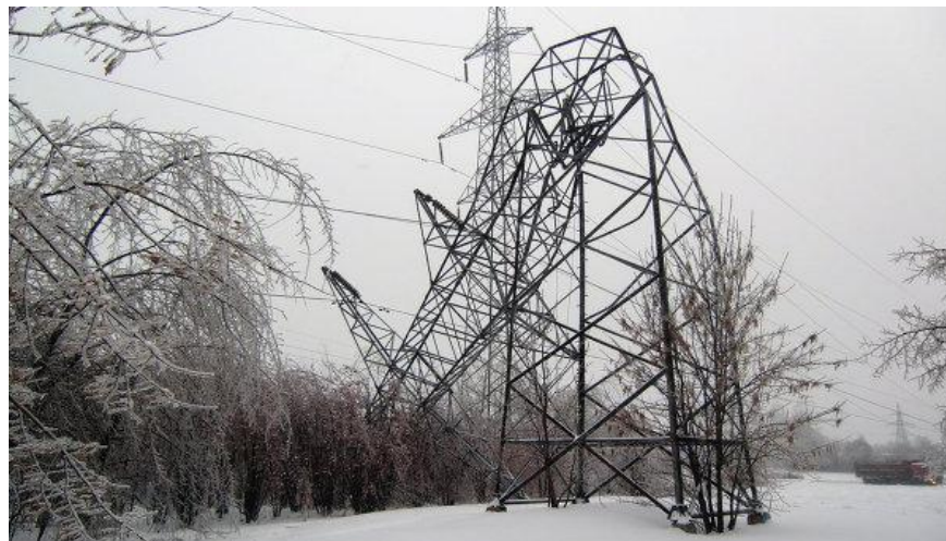
Рисунок 2. Опора ВЛ, деформированная под весом гололёдных отложений.
