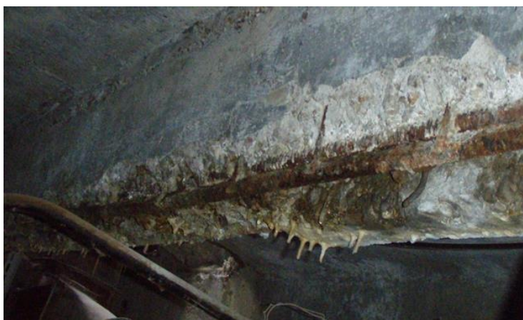
Рисунок 1. Коррозия бетона и арматуры железобетонной плиты
