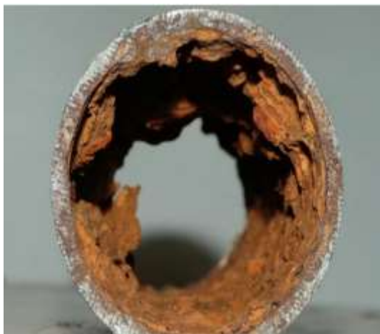
Рисунок 1. Труба, пораженная коррозией
