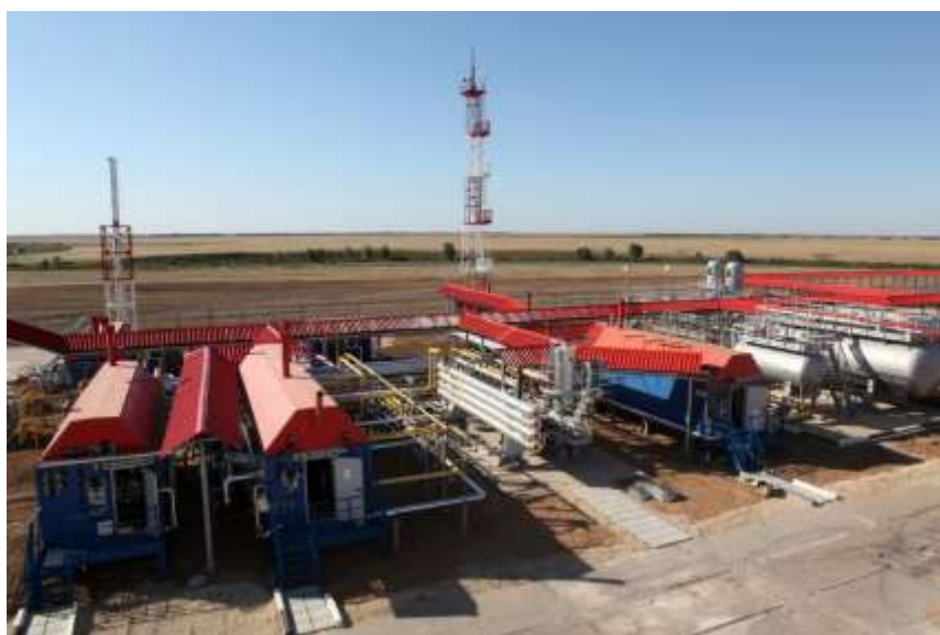
Рисунок 1. УКПГ производства экспериментального завода ООО «ТюменНИИгипрогаз»
