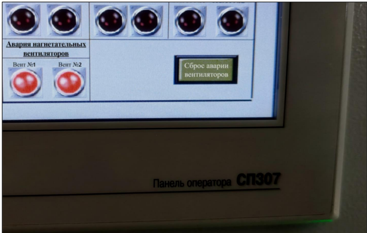
Рисунок 4. –Авария в работе нагнетательных вентиляторов на панели оператора
